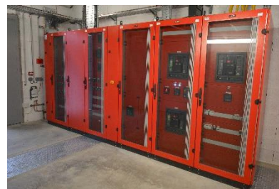
Photo 7 : Tableau général basse tension - voie rouge
